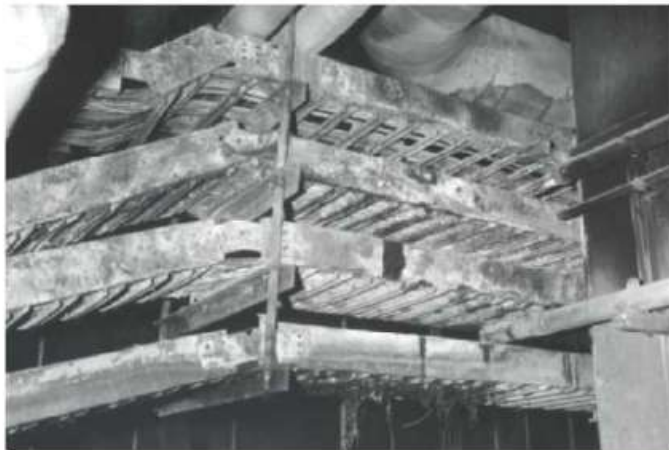
米国の火災防護規制強化のきっかけとなったBrowns Ferry 1号機のケーブル火災(1975年3月22日発生)
