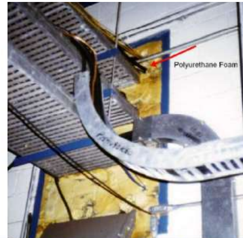
BF 1の火災の一因となったケーブル・トレイ貫通部のシール材の例
