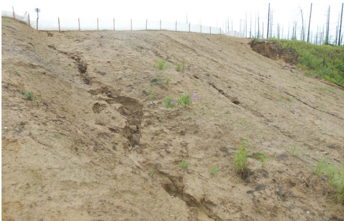
オオワシ繁殖地の直近のサケマス遡上河川で認められる土砂流入 多数の土壤崩壊(エロージョン)が発生している。オオワシの繁殖期中なので、改修工事を行なうことができないと地元担当者はいう。オオワシの巣を回避せずにパイプを敷設したのが根源。
