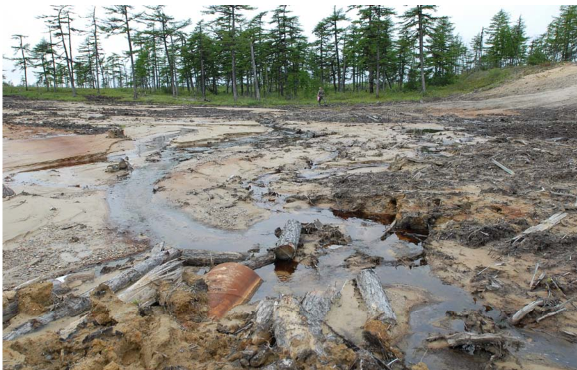
カラフトアオアシシギの生息する湿原、沢への土砂の流入 この場所はサハリン1のパイプライン(既設)と並行してサハリン2のパイプライン敷設準備が行なわれて行われている。
